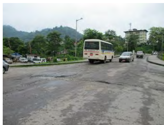
(ii) 橋の接続部交差点の舗装劣化
