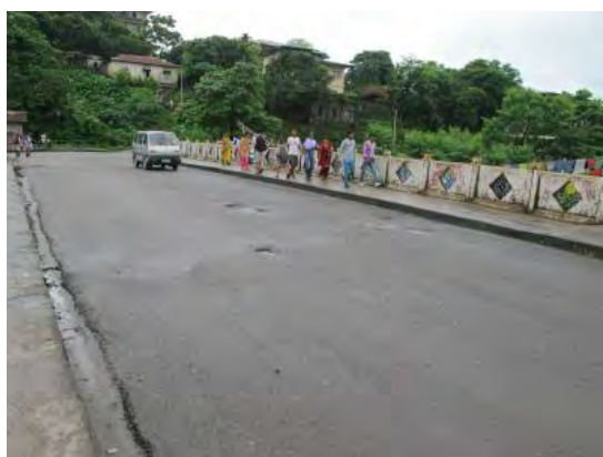
(i) 橋梁上の劣化状況
