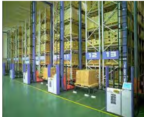
高度機能倉庫(屋内)
