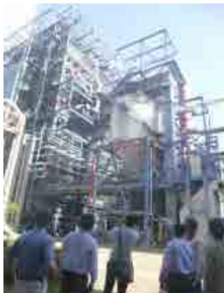
磯子火力発電所の排煙脱硫装置。環境負荷を大幅に低減した技術に関心が集まった
