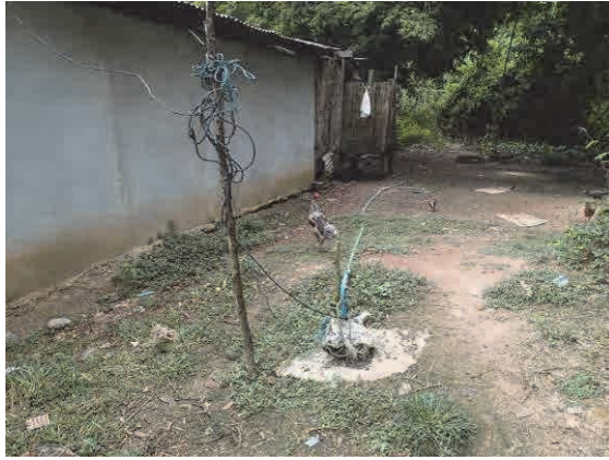
使用中の深井戸
