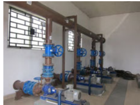
水公社の小型浄水場 - ポンプ室
