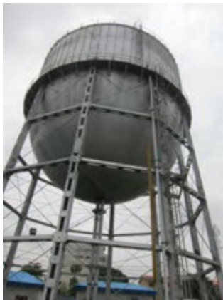
水公社の小型浄水場 - 高架タンク
