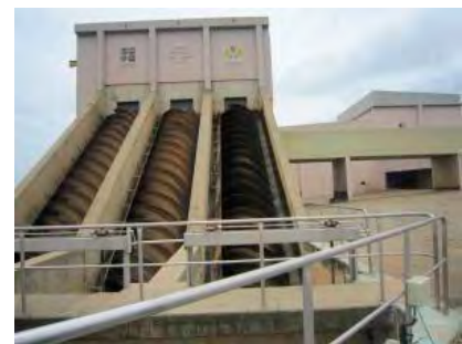
流入下水リフトアップポンプ(スクリュウポンプ)
