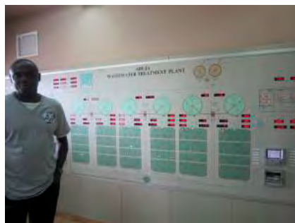
管理棟内のコントロールパネル
