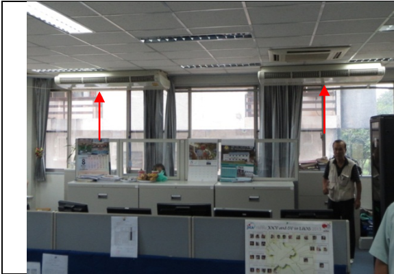
DMH の上部官庁である天然資源環境省により 2011 年末に 気象予報室に新たに据付けられた 2 台の空調機 (冷房)
