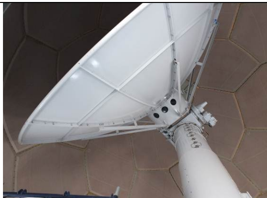
レドーム室：8 階 (レーダーアンテナ)
