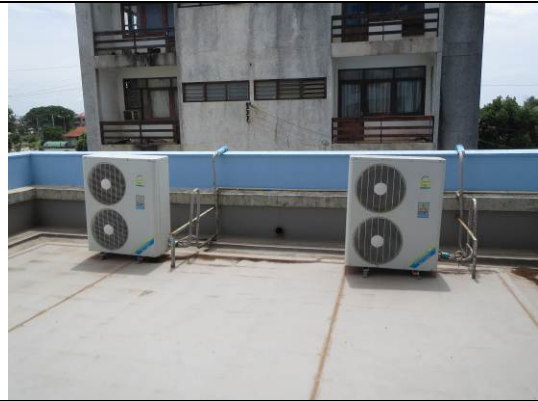
天然資源環境省により気象予報室に新たに据付けら れた 2 台の空調機の屋外ユニット
