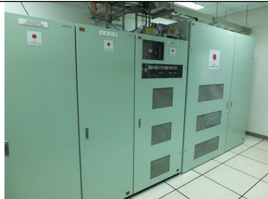
レーダー機械室：6 階 (送信装置、受信信号処理装置、空中線制御装置)
