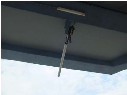
観測デッキ：7 階 (気象データ通信システムのアンテナ)
