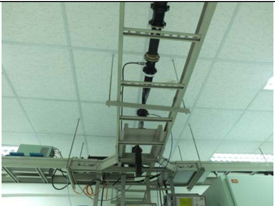
レーダー機械室：6 階 (導波管)
