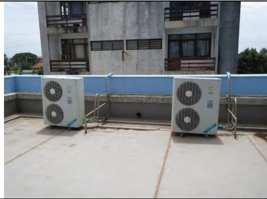
天然資源環境省により気象予報室に新たに据付けら れた 2 台の空調機の屋外ユニット
