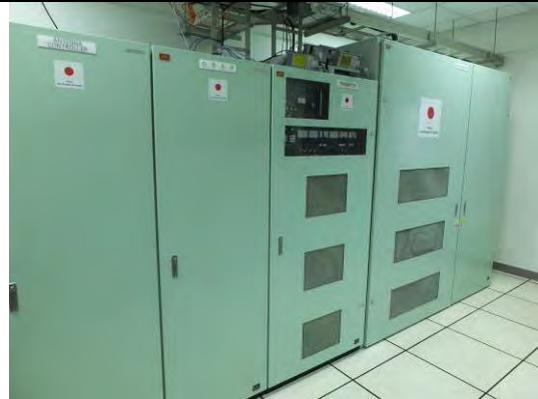
レーダー機械室：6 階 (送信装置、受信信号処理装置、空中線制御装置)
