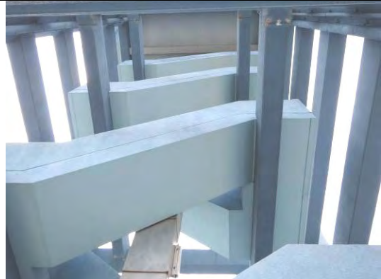
2011 年末～2012 年 3 月に実施された JICA のフォロー アップにて塗装された屋外階段段裏
