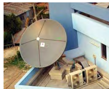
写真 既設気象衛星データ受信システムのアンテナ
