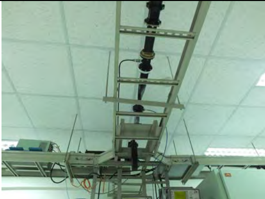
レーダー機械室：6 階 (導波管)
