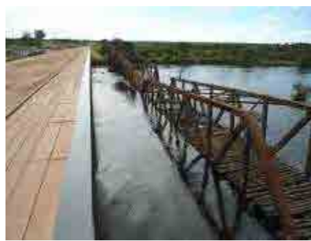
破壊された橋梁 クアンザ (Kuanza) 川
