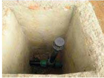
サイホン頂部（注水口）
