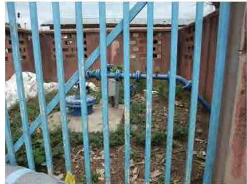
グラズエ市、SONEB の SF1 井戸、過剰揚水により動水位が下がり、乾季には揚水不能となる
