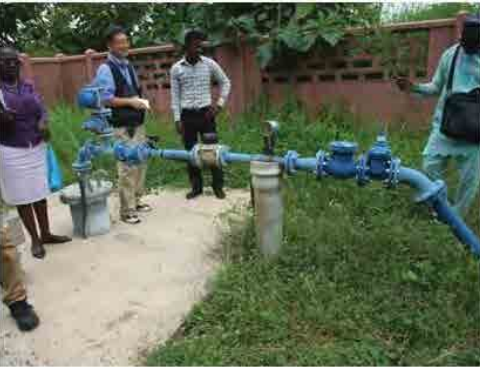
グラズエ市、SONEB の Adjanou 井戸、揚水量 13m³/時で 24 時間運転、乾季でも揚水量は変わらない
