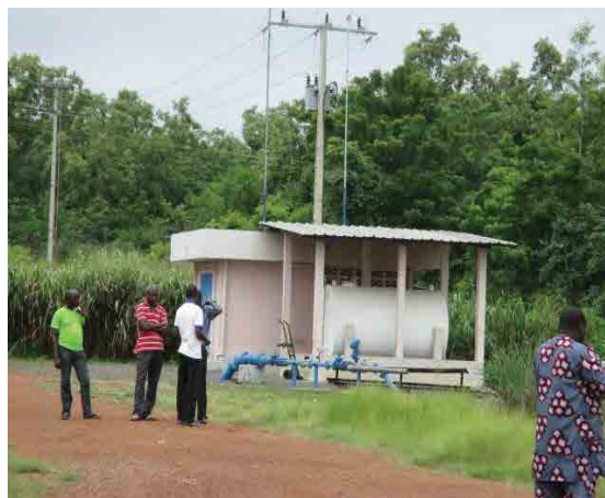
SONEB コントロールハウス 2013年8月27日 SONEB 職員が常駐して管理している。
