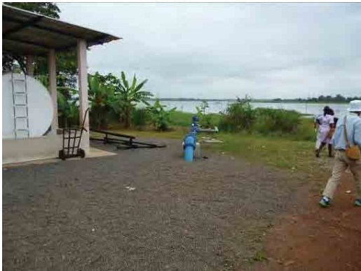
イロコ湖取水場。湖中央にあるフローティング型の取水から浄水場へ送水している。
