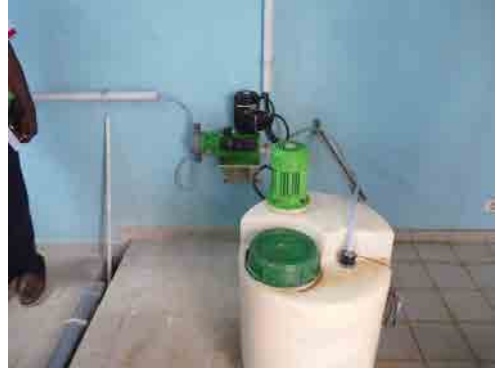
同水源地の塩素滅菌装置。
