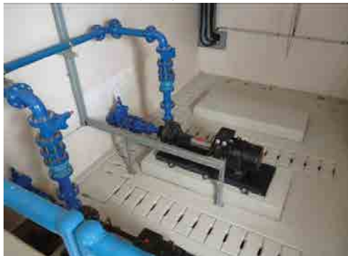
本送水ポンプでサベ市の配水池へ送水している。
