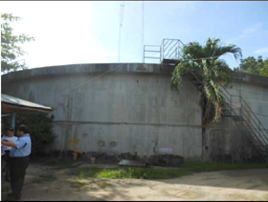
写真-3:ティサ配水池 井戸から取水された水が一時的に貯留され、送水されている。流出管に流量計が無く、不断水弁を用いて設置する予定。
