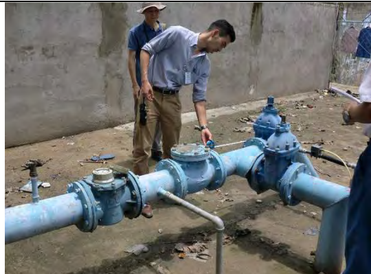
写真-6:CAM 1 井戸ポンプ 市中の井戸ポンプ場の露出配管。流量計は設置されているが機械式であり、常時モニタリングが難しい状況にある。
