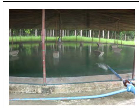
写真-5 Tisa 浄水場（浄水池）
