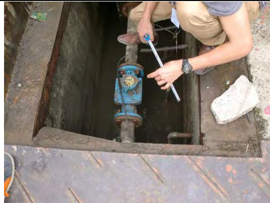
写真-10:配水ブロック流量計
