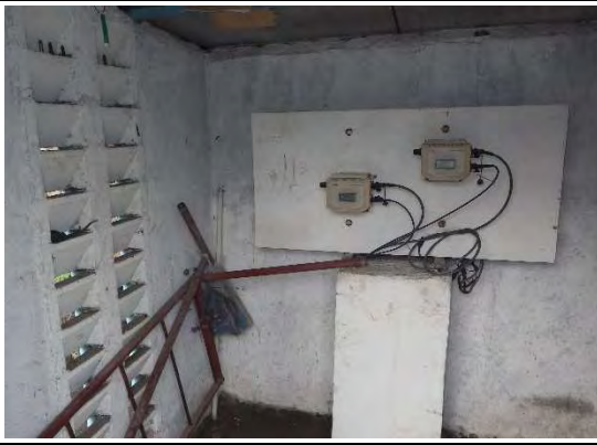
写真-4:水供給業者の流量計 通信機器を設置して買取り流量をメトロセブ水道区側で確認することにより、適正な支払金額を確保するとともに、配水量の把握が容易となる。
