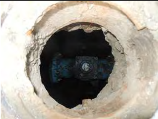
写真-9 配水ブロック流量計
