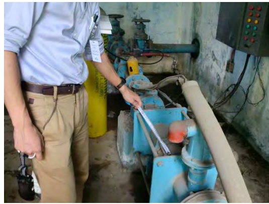
写真-8:L3 井戸ポンプ
