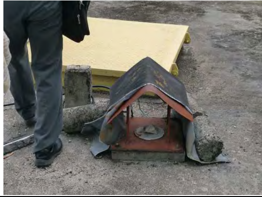
写真-2:ティサ配水池 配水池上部に設置されていた水位計のカバー。水位計本体は故障のため取り外されている。
