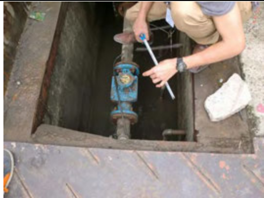
写真-10: 配水ブロック流量計
