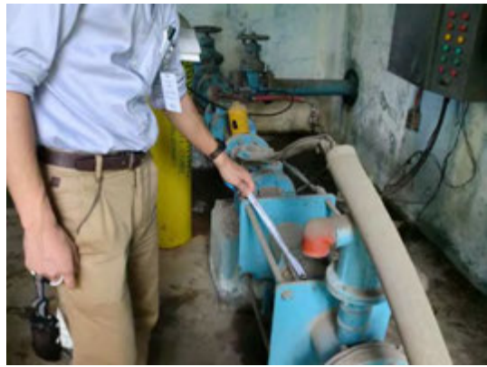
写真-8:L3 井戸ポンプ
