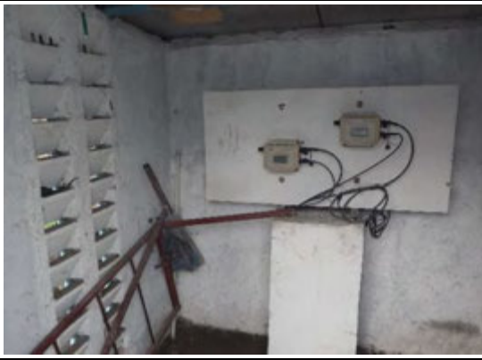
写真-4:水供給業者の流量計 通信機器を設置して買取り流量をメトロセブ水道区側で確認することにより、適正な支払金額を確保するとともに、配水量の把握が容易となる。
