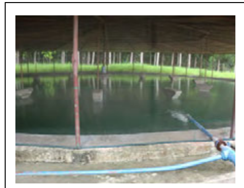
写真-5 Tisa 浄水場（浄水池）
