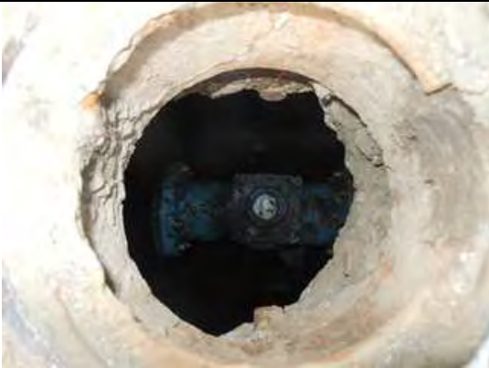
写真-9 配水ブロック流量計
