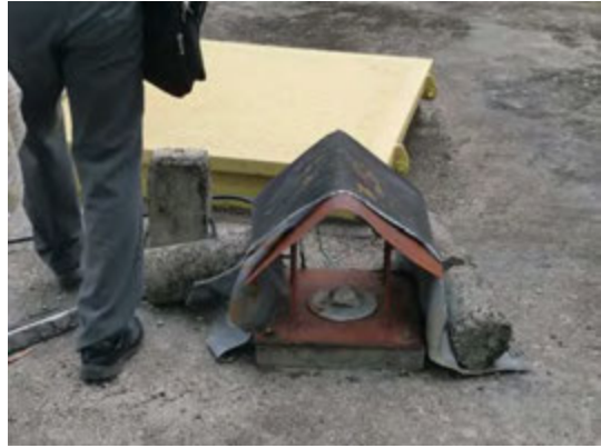
写真-2:ティサ配水池 配水池上部に設置されていた水位計のカバー。水位計本体は故障のため取り外されている。
