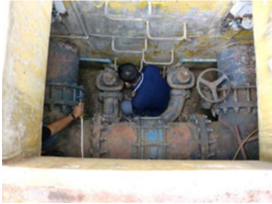
写真-1:ティサ配水池 配水池出口の配管ピット内。ピット内にバルブは設置されているが、流量計は設置されていないため、下流側に新たな流量計ピットを建設する。
