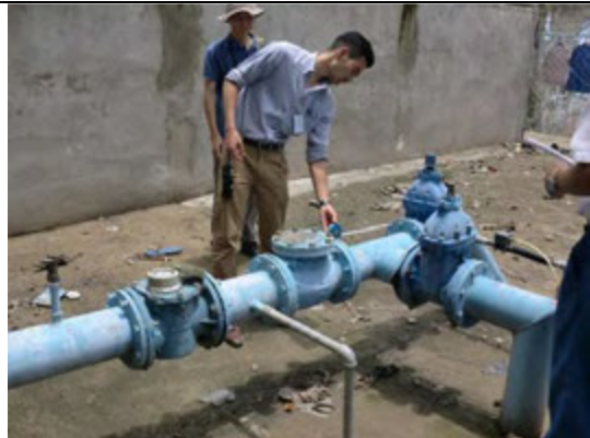
写真-6:CAM 1 井戸ポンプ 市中の井戸ポンプ場の露出配管。流量計は設置されているが機械式であり、常時モニタリングが難しい状況にある。
