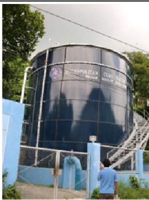
写真-5:B. C. ホームズ配水池 2012年にバランスタンクの機能(夜間に貯留し日中に配水する)を有する配水池が建設された。今回は機械式の水位計のみが設置されている。
