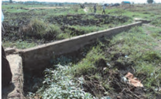
ため池の越流堰、修繕が行われず放置されている。
