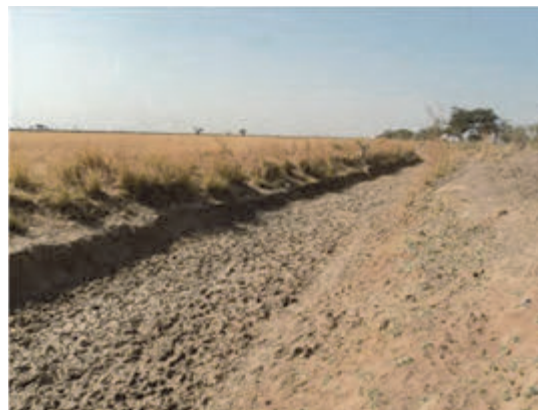
地区内の灌漑水路。上流からの流砂が堆積して通水断面を狭小にしている。維持管理体制の整備が望まれる。
