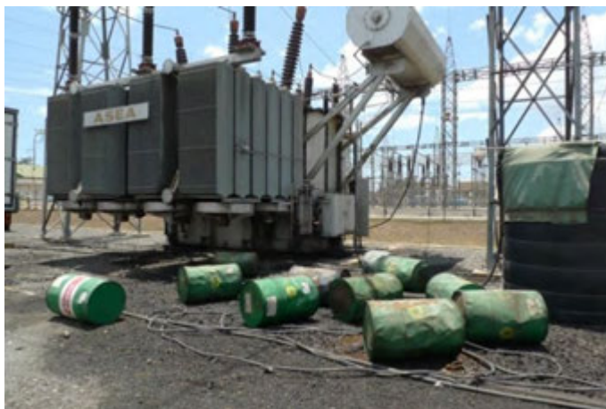
図 2-2-3-1.5 防油堤が設置されていない
