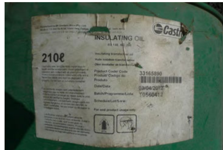
図 2-2-3-1.6 変圧器の絶縁油ドラム缶のラベル
