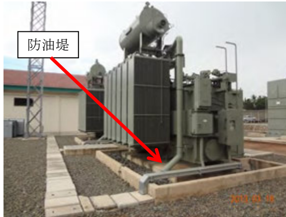
図 2-2-3-1.9 変圧器下の防油堤
