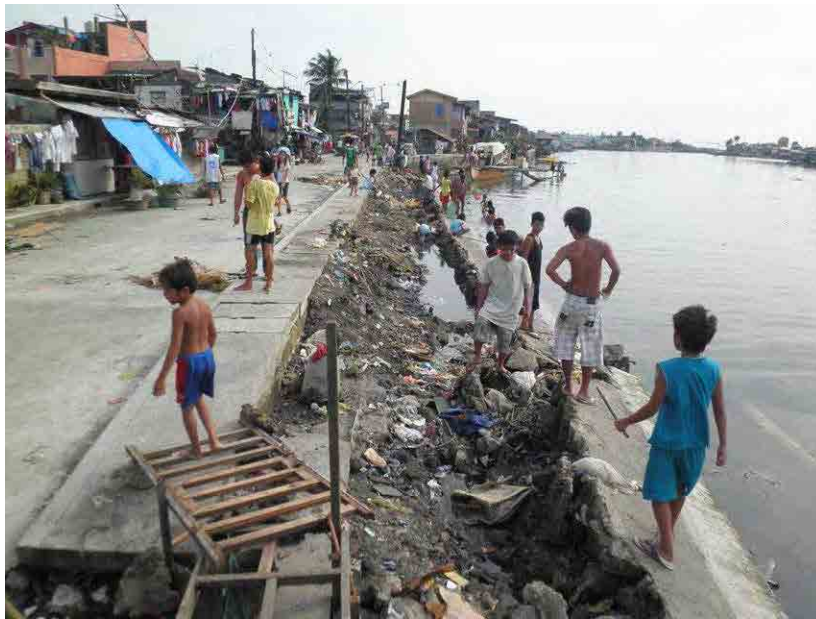
図 5.10.4 マララ川左岸の倒壊した洪水防御壁
