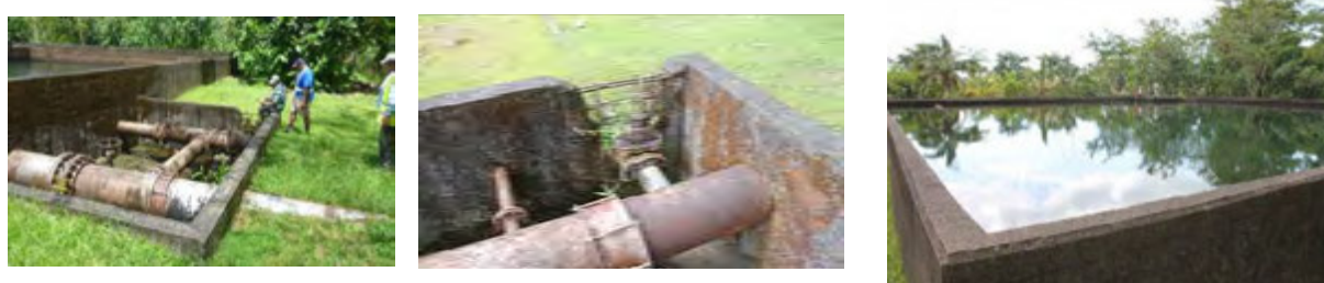
手前の管路が、水源地から EPC 貯水池への導水管。バルブボックス内で分岐し、奥側の管からさらに分岐し SWA の水源として使用される
