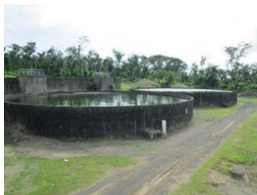
砂ろ過池 生物活性が高い。
