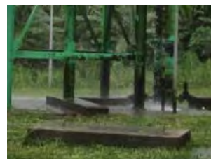
ろ過機が閉塞し上部から水が溢れている
