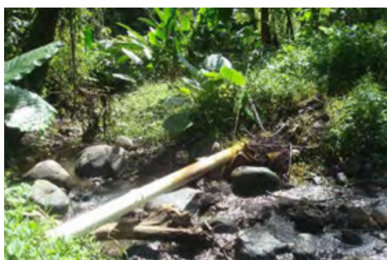
タパタパオ西側の既設導水管の漏水状況。空気弁がないため、管に直接穴を空けて空気を抜いているが、それと同時に水も失われている。
