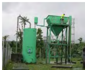
Fagalii 浄水場急速ろ過機
