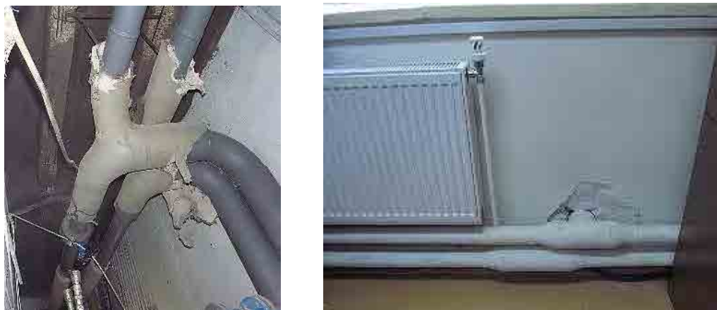
図 2.3.2-12 DSI ビルパイプシャフト内および室内の非断熱配管
