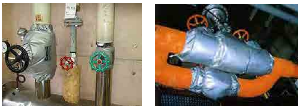
図 2.3.2-16 バルブ断熱ジャケット
