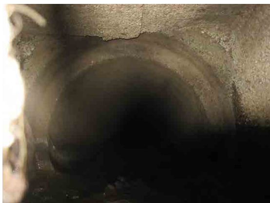
OH-36: 継手部の脱落
