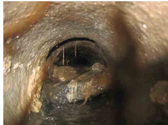
ST-25: 部分的な破損
