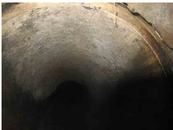
OH-22: 継手部の脱落
