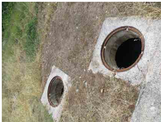
マンホール蓋も盗難に遭っている
