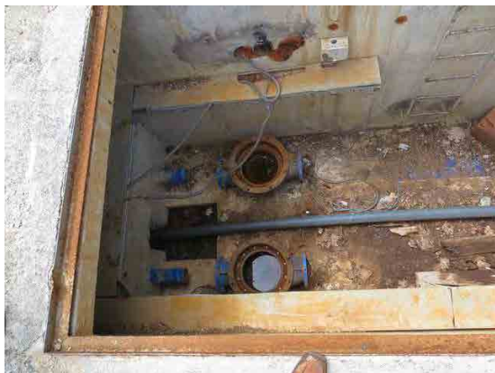
機器類が失われた Elen Kamen ポンプ場 出典：JICA 調査団
