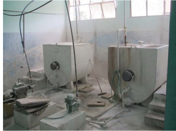
Inyección de cal hidratada para controlar pH. Los polvos de cal se dispersan.
