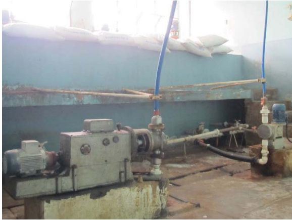
Inyección de sulfato de aluminio para flocurador. El químico en bolsas está colocado a la ventana.
