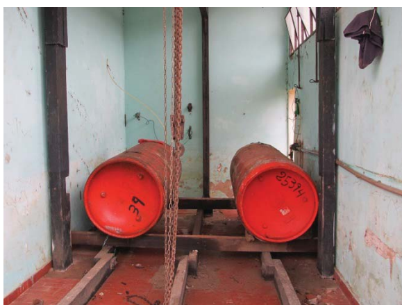
Lugar de inyección actual de gas de cloro
