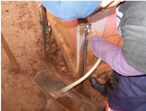
設置No.1 家庭用屋外水栓をはずして耐圧ホースを設置
