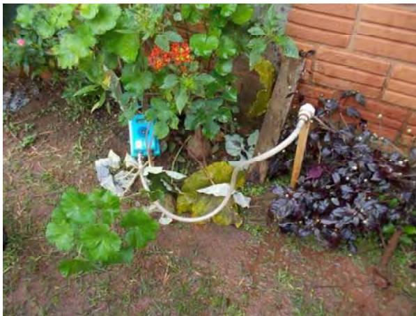
設置No.6 屋外での水圧データロガー設置状況
