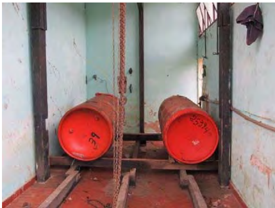
現在の塩素ガス注入場所
