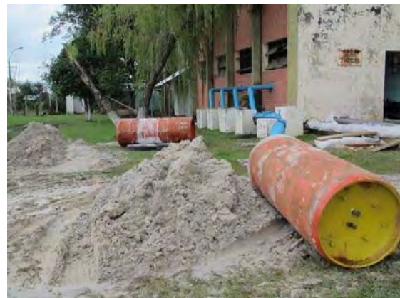
交換後、放置されているガスボンベ
