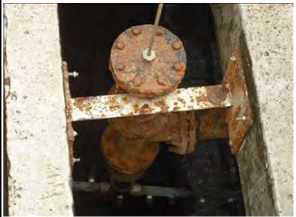
No.8 表面洗浄装置 本年2月から2池を補修中であるが、7月現在、未完了である。表面洗浄装置には錆が立ち、老朽化が明らかである。
