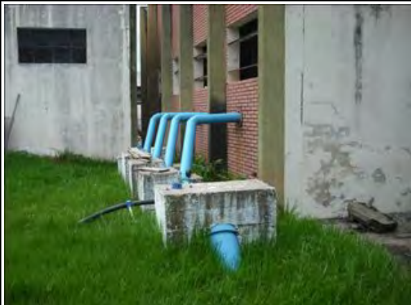
No.11 コロネロオビエド市向けの送水管 ポンプ周りには水圧計がなく、送水管の基点には水圧計が設置されているが、25kgf程度が検針されているが、水圧データロガーによる測定結果によれば、12~13kgf/cm 2 とされた。
