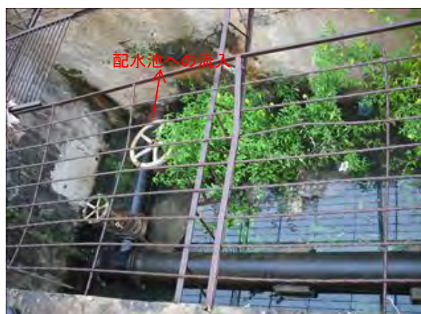
No.11 配水センター内、配水池の流入弁室 半地下式配水池は内部が2つに分けられている。流入弁の蓋は鉄筋だけで、雨水が溜まり植物が発生しているなど維持管理が不十分である。なお、流入管には超音波流量計が設置され流入量が計測されている。
