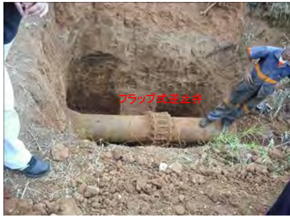
No.7 既存送水管の状況 2012年に水撃圧による管路損傷が発生した際、送水ポンプの急停止、バルブ操作の誤りなどが重なり、途中に設置されていた逆止弁が水撃圧で破壊された。
