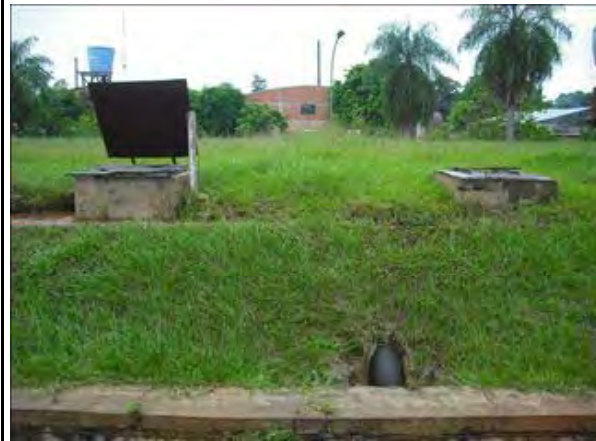
No.10 同配水センター内、半地下式配水池 容量1,400m 3 の鉄筋コンクリート式の配水池。池底盤付近からの漏水が推定されている。パ国側はセンター敷地内に新たに1,500m 3 の配水池を建設する予定である。
