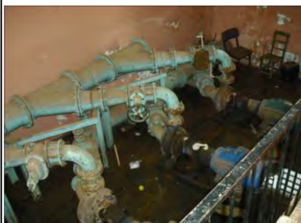
No.12 配水センター内高架式配水池への揚水ポンプ 地上式配水池の水を高架式配水池に揚水するためのポンプが3台ある。
