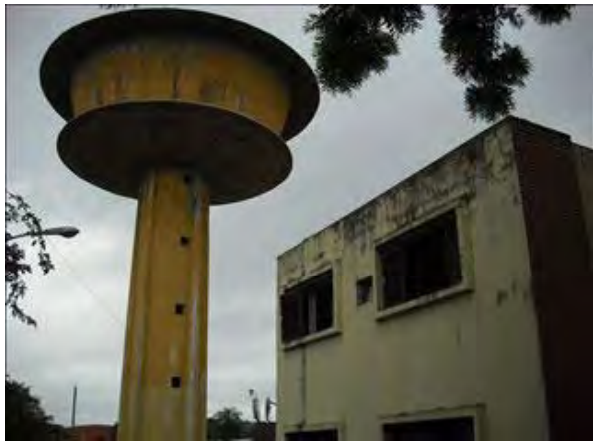
No.9 コロネルオビエド配水センター 浄水場から送水された水は配水センターを通じて、各戸配水されている。地上式配水池(容量1,400m 3 )と高架水槽(容量500m 3 )がある。
