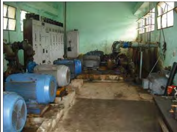
No.9 送水ポンプ室 手前左の4台はビジャリカ市向け、奥の4台はコロネロオビエド市向けの送水ポンプ。全ての設備は老朽化が著しく、一部は逆止弁が壊れたままである。
