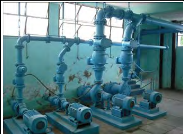
No.12 逆洗・表洗ポンプ 逆洗・表洗ポンプは稼働している。昨年、品質改善の対策が施されたことにより、ろ過池の洗浄は改善されたとのことであった。
