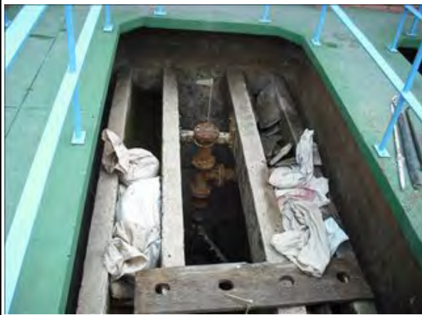
No.7 急速ろ過池の内部 砂層による急速ろ過池(6池)を採用している。ろ過砂(アンスラサイト併用)の洗浄には、逆流洗浄と表面洗浄方式が採用されているが、表面洗浄は故障のため稼働していない。
