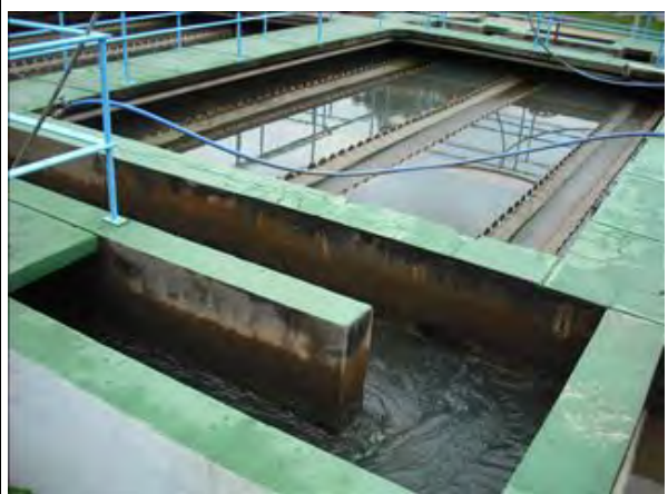
No.6 沈澱池 フロック形成池から上向流・傾斜管(塩ビ製)式沈澱池4池にて懸濁物質が除去される。沈澱池上流部にはVノッチ堰トラフが設置され、上澄水がろ過池へ導かれる。
