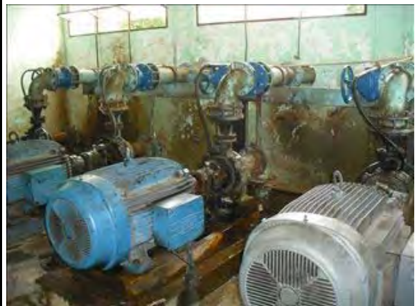
No.10 コロネロオビエド市向け送水ポンプ ポンプはすべて同じ出力であり、市内の配水池の水位情報を見ながら台数制御運転を行っている。ポンプ稼働時の手順が順守されておらず、水撃圧によって頻繁に設備の損傷が発生する。
