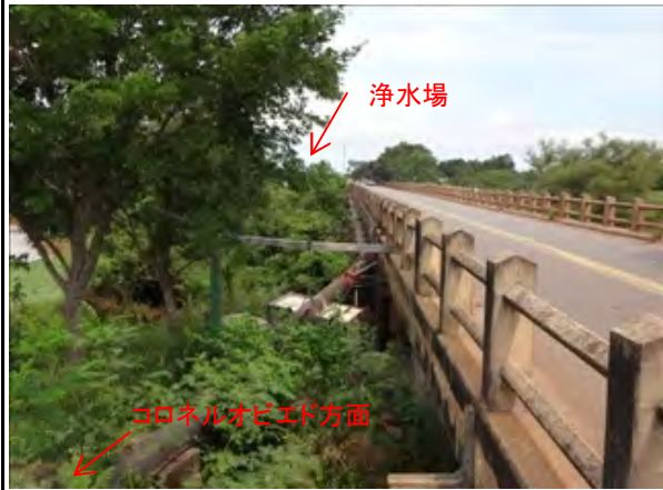
No.8 既存送水管の状況 浄水場近辺の導水管(DIP φ 350mm, US PIPE)のテビクアルミ川橋梁添架部。本橋梁は新しく架替えられるが、洪水対策として2.7m嵩上げされ、2013年7月から工事が開始される。MOPCが事業主であり、新規送水管φ 500mmの添架が設計段階から盛り込まれている。
