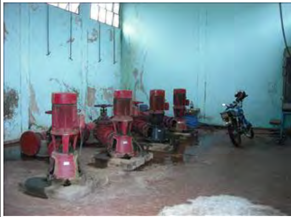
No.3 取水ポンプ 縦軸斜流ポンプが4基(3台常時、1台予備)存在する。これまで何度も修理を繰り返しており、老朽化が著しい。また、騒音や振動も大きく、ポンプ基礎のひび割れもみられる。
