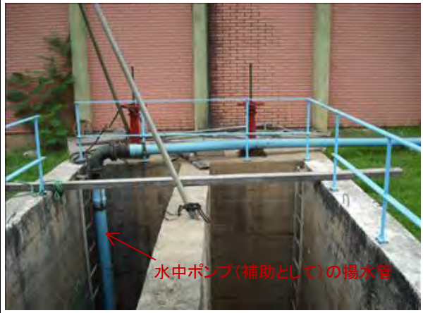
No.2 沈砂池 河川に突きだした取水管路(φ600mm)から沈砂池に導水される。既存取水ポンプを補うために、沈砂池に直接水中ポンプを設置している。
