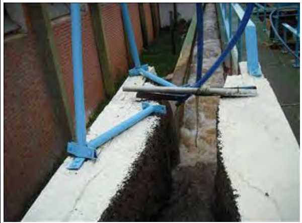
No.4 薬品混和水路 取水された原水は着水井に送られ、直後のパーシャルフリュームの下流部で硫酸アルミニウムと消石灰が混和される。パーシャルフリュームで流量が測定されているが、老朽化により精度は不確実である。
