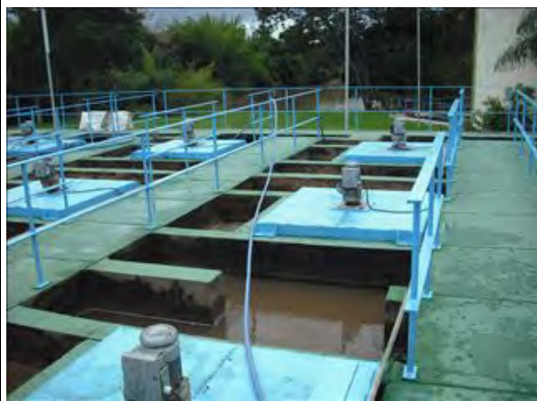
No.5 フロック形成池 ゆっくりとしたモーター攪拌方式により、フロックの成長を促進するが、モーターは全て故障し稼働していないため、十分な効果は出ていない。
