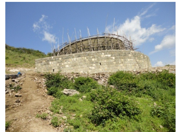
⑭ Dera 町の新給水システムの配水池。約 25km 離れた Hurta 付近の湧水から送水される。近々完成される。
