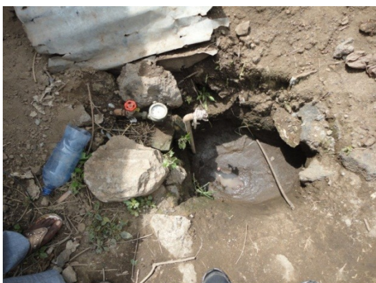
⑦ Awash Melkasa 町の各戸給水栓。水圧不足のため地表付近で配管を切断し、受水している。
