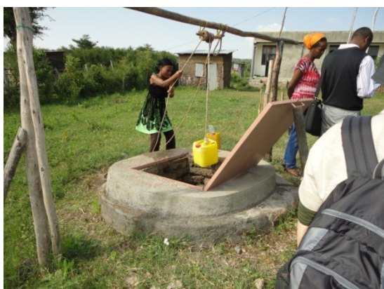
③ Ude-Dhankaka 町の Ude 地区の手掘り井戸。8 年前に完成し、3 家族で使用している。水量は安定している。
