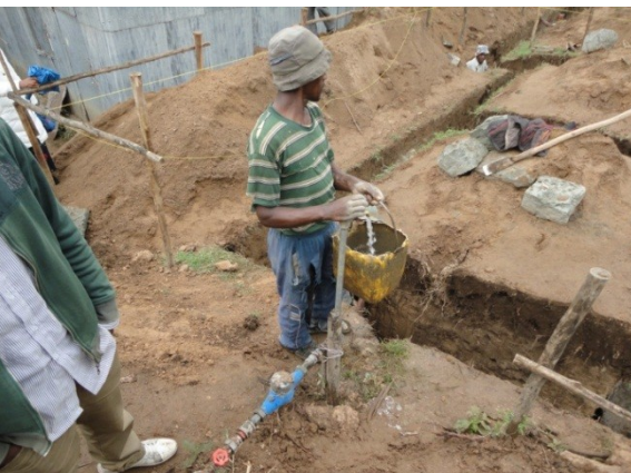
⑬ Hurta 町の民家水道。1983 年完成の施設 (湧水が水源) がある。新規水源による拡張事業が近々完成される。
