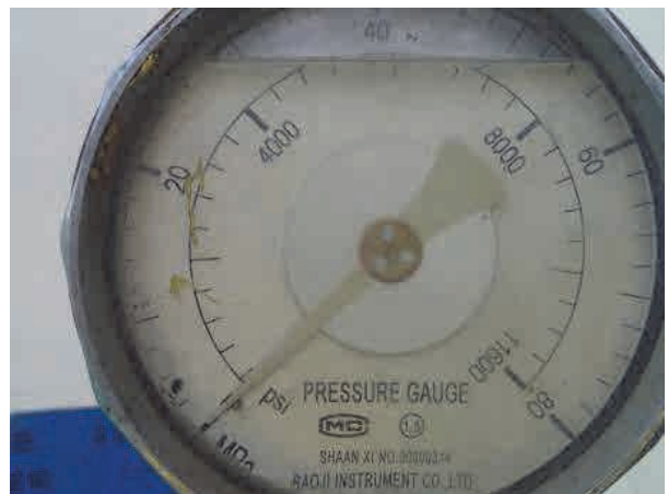
故障中のマッドラインの圧カゲージ
