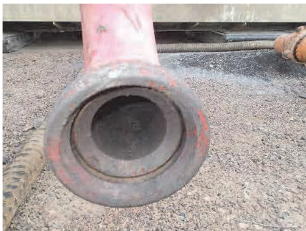
高圧配管のシールは1個のOリングのみで貧弱
