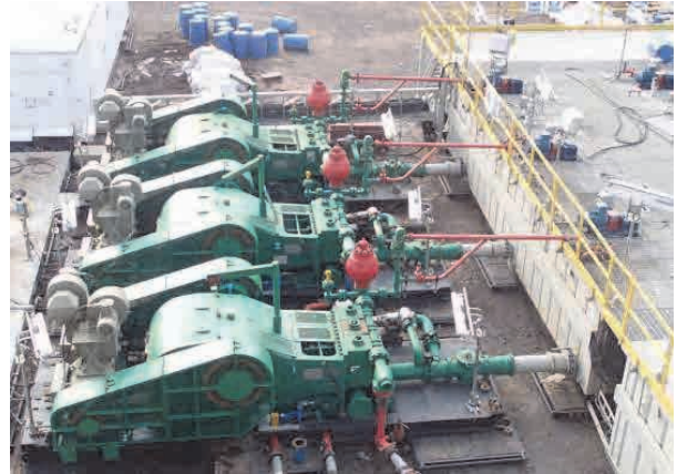
新しいリグの泥水ポンプの高圧配管のリリーフバルブ排出口
