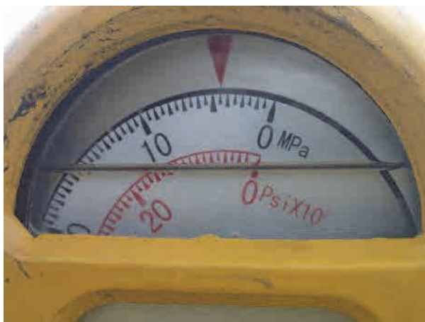
泥水ライン圧カゲージ
