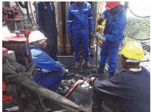
DP 用パワートングのアームのシリンダーが変形。クルーが整備中。
