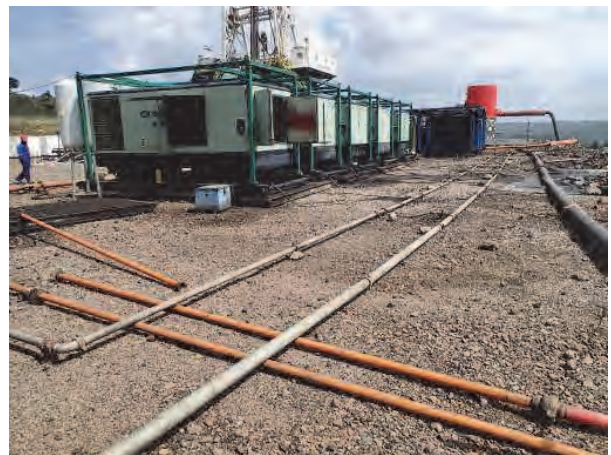
燃料ラインからの漏れ
