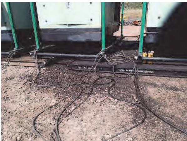
燃料ラインからの漏れ
