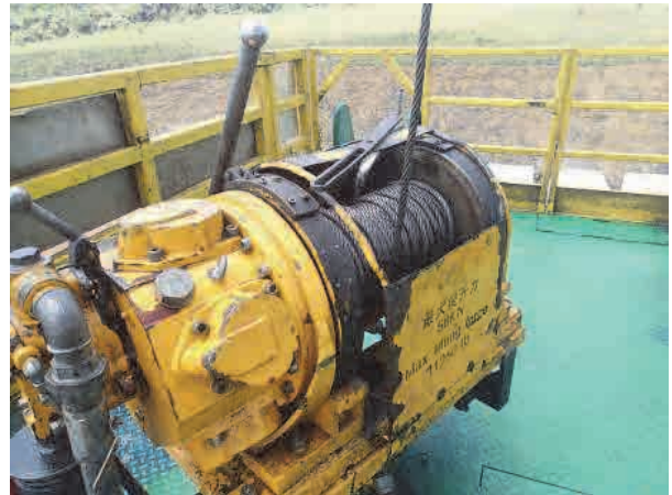
エアホイスのラインは磨耗及び変形している。交換が必要。
