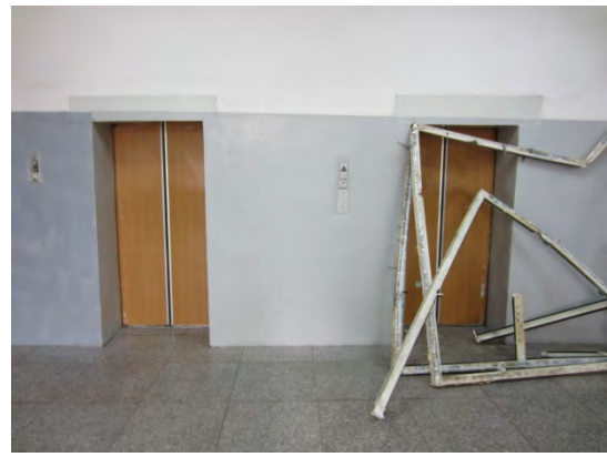
写真 躯体のゆがみにより使えなくなったエレベーター
