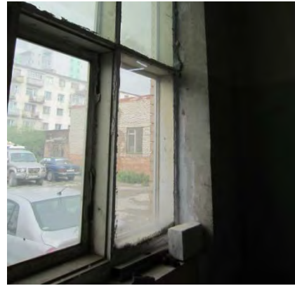
写真 改修されていない開口部
