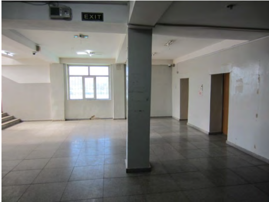
写真 エレベーターホール 柱が傾いている
