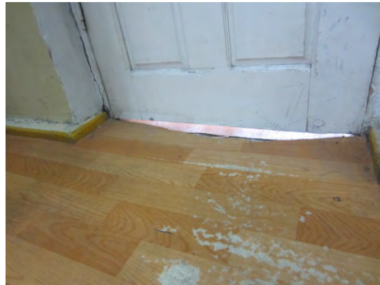
写真 床がたわみ扉の下部に隙間ができている
