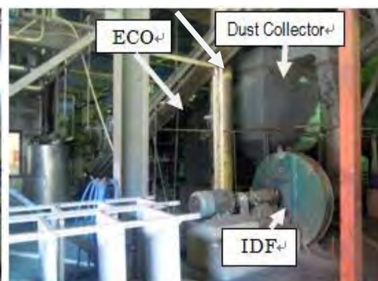
図 4-16 産業ボイラ後部
