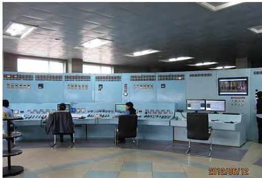
図 4-9 1～3号機タービン 運転監視盤 (右端部は熱供給関連の監視部分)
