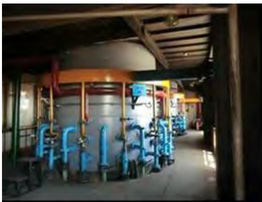
図 4-33 乾留炉中段燃焼箇所
