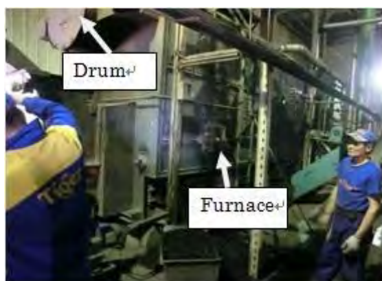
図 4-15 産業ボイラの側面
