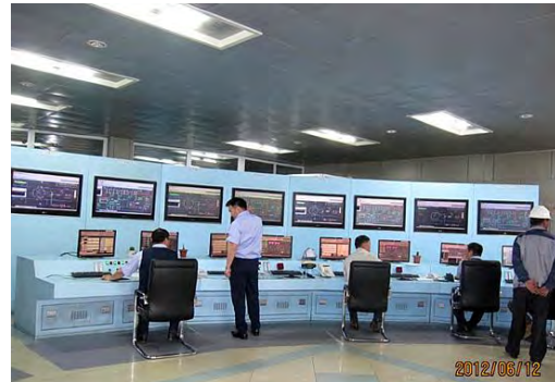
図 4-10 1～4号ボイラ 運転監視制御盤
