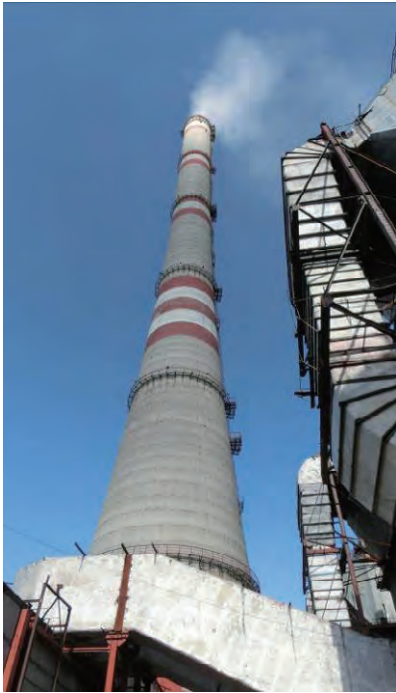
火力発電所 No. 4 の煙突
