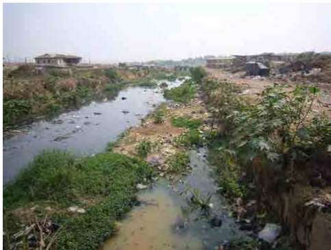
クマシ市内の排水路は、土砂の堆積、ゴミの投棄、家屋の不法占拠などが問題
