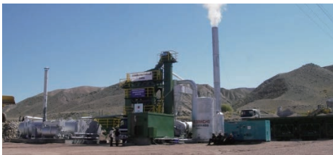
15. アスファルトプラント
