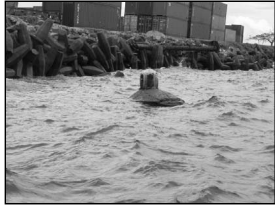
写真-26 東側護岸沖のボラードの状況
