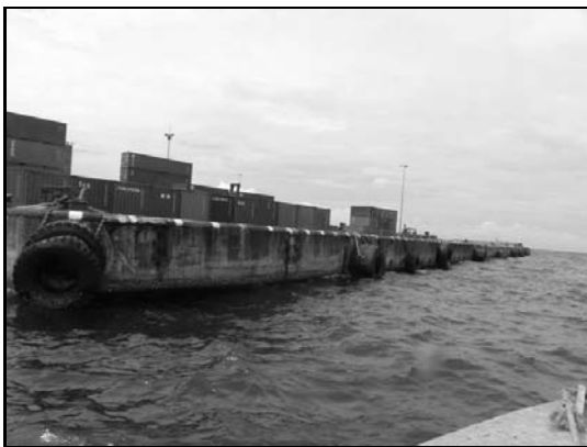
写真-5 国際埠頭岸壁前面の状況
