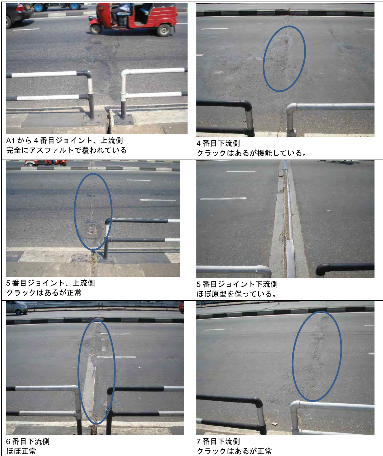
図 2. 4. 6 伸縮継手の損傷 (2/3)
