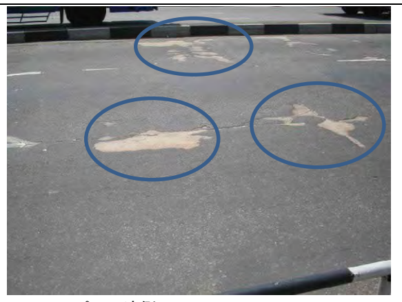
P8-P9 スパン下流側 アスファルト厚が少なく床版 コンクリートが露出し ている。
