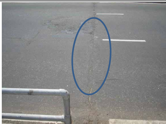
A1 から 2 番目のジョイント、上流側 ジョイント部上にクラックはあるが正常に機能している。
