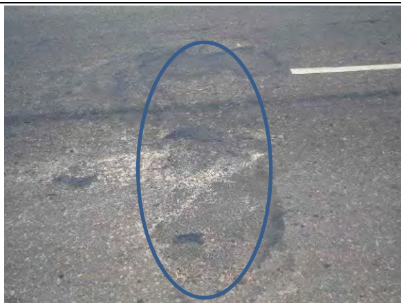
A1 から 3 番目のジョイント、上流側 クラックはないが表面に不陸あり
