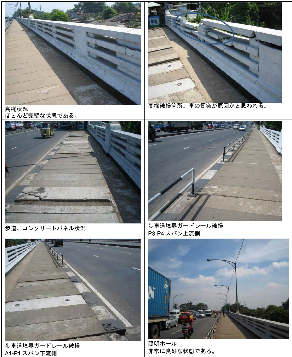
図 2.4.8 その他橋梁付属物の損傷
