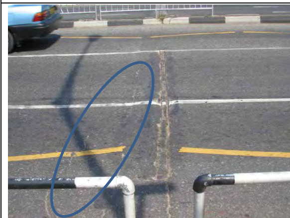
伸縮継手付近のクラック
