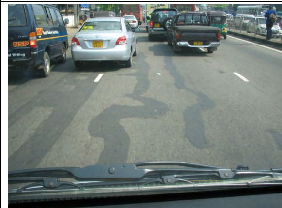
Orugodawatta 近くの Base Line road アスファルトクラックの修理跡有り
