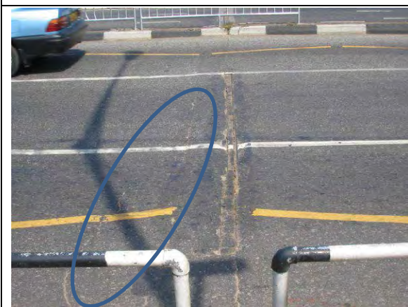
伸縮継手付近のクラック
