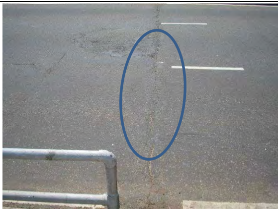
A1 から 2 番目のジョイント、上流側 ジョイント部上にクラックはあるが正常に機能している。
