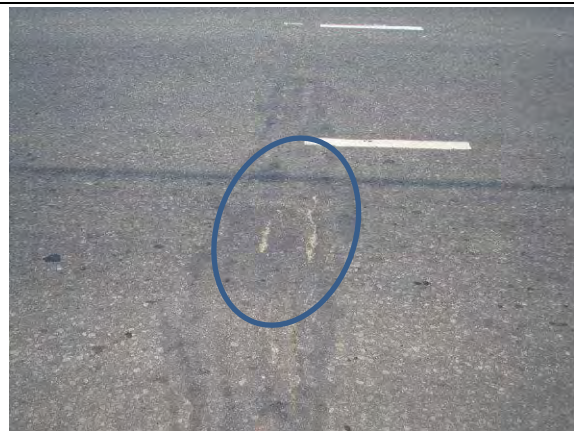
同、下流側 若干のクラックあるが正常
