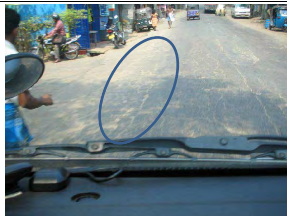
Stace road, たくさんのクラック不陸がある。修理が必要。
