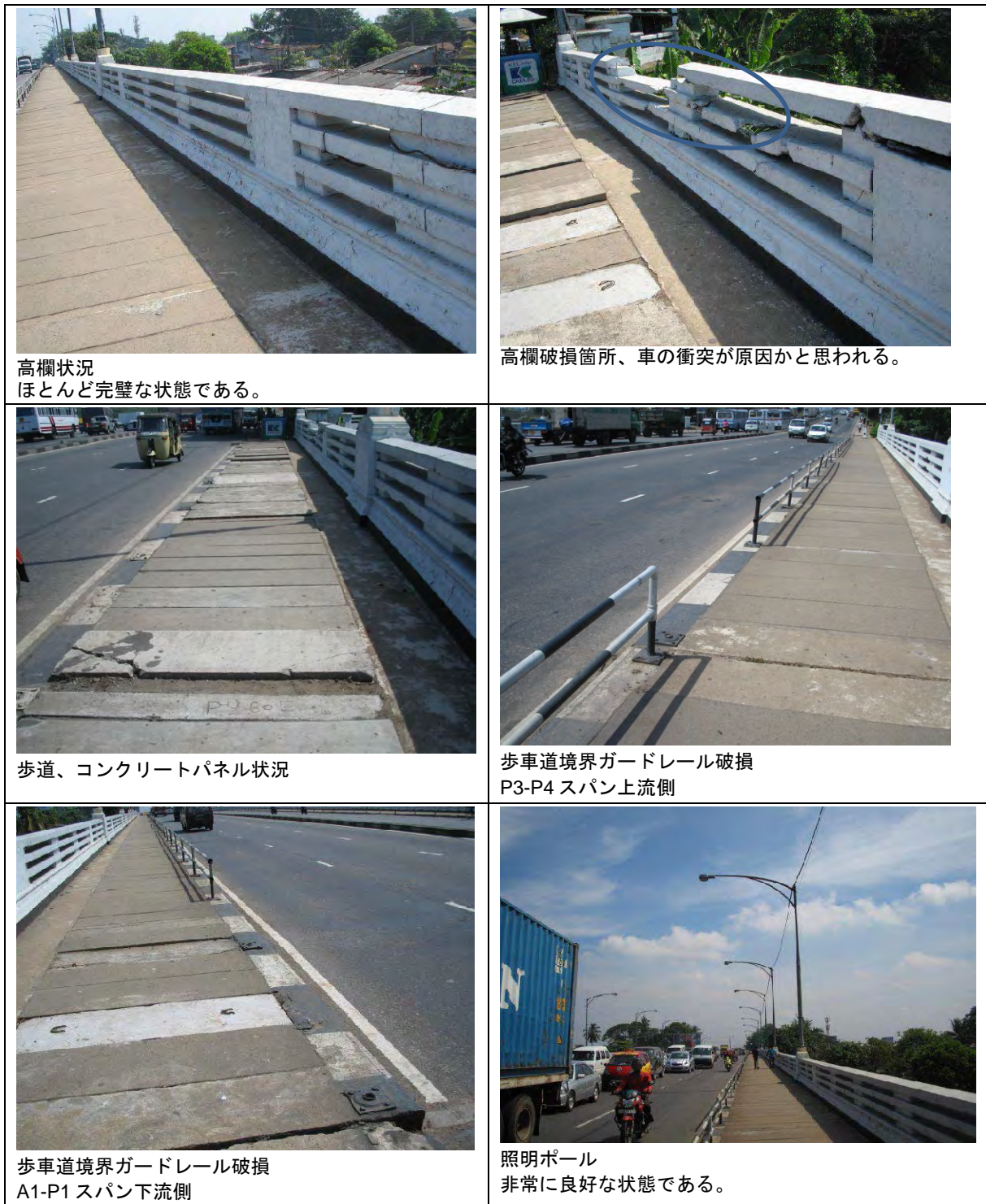
図 2.4.8 その他橋梁付属物の損傷
