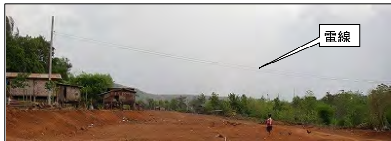
図 2-2-1 工事中に支障となる電線
