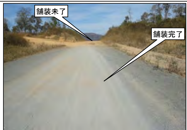
写真-8 : 国道 16B 号 (ダクチュン側) の舗装状況
