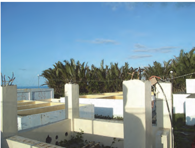
ナウハンふ化場の台風被害 （培養タンクの屋根が破壊されている）
