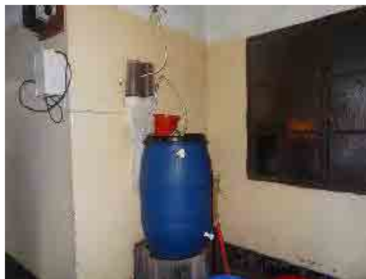
【写真 3-5-6-5 : パイロット機設置 2012 年 9 月】
