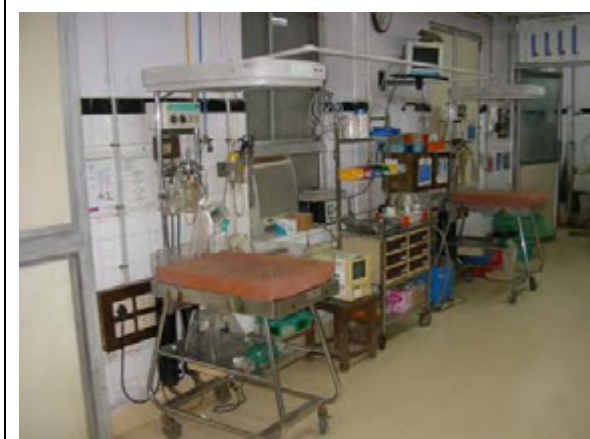
チェンナイ小児病院本館：救急部門 本館1階正面玄関の奥に位置する救急部門の室内状況と、そこに設置されている救急機材の状況。
