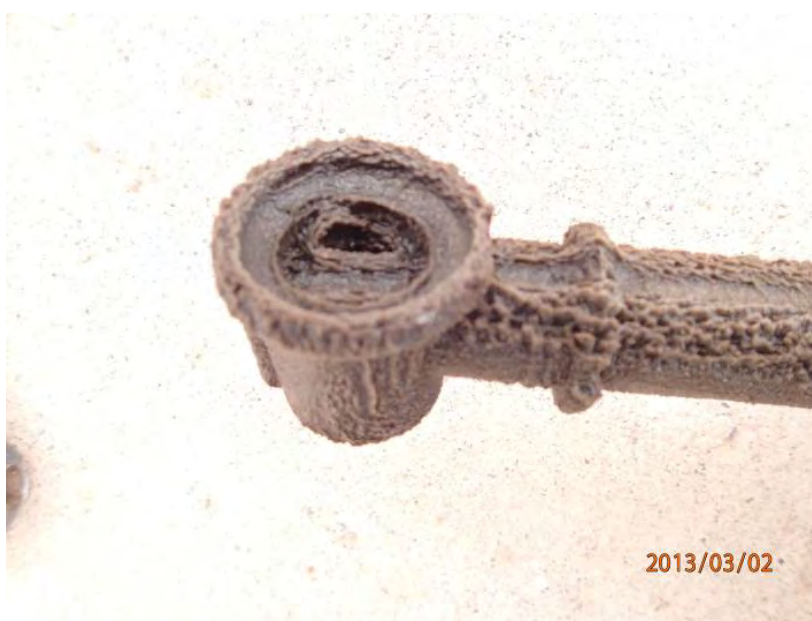
Encrustación en el sensor del medidor de flujo para agua caliente Vortex
