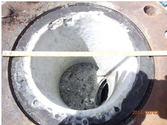
Precipitación de encrustación del cabezal en el pozo SM-2
