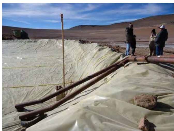
Tubería de fosa
