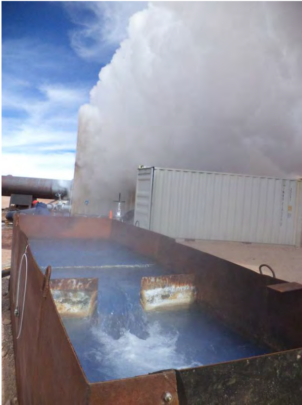
Caja vertedero durante la prueba de producción
