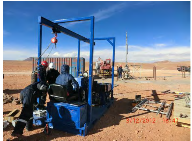
Tubo capilar en el pozo SM-3
