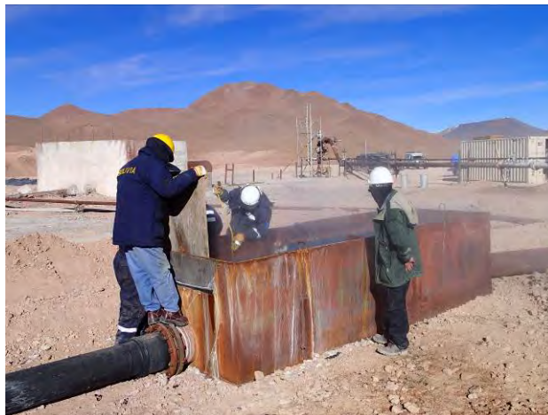
Medición en la caja vertedora durante la prueba de producción en el pozo SM-2
