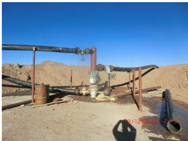
Tubería del cabezal en el pozo SM-4
