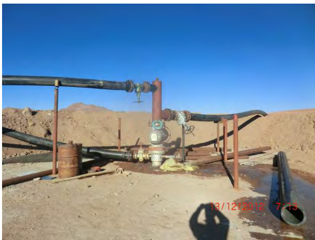
SM-4 の坑口配管
