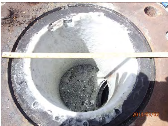
SM-2 の坑口装置に析出したスケール
