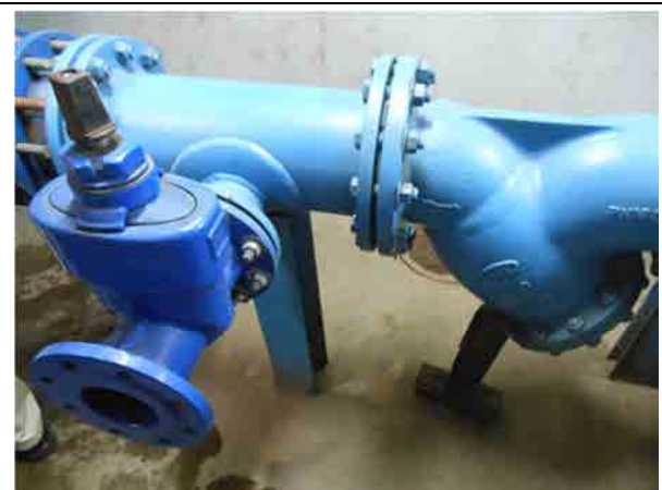
パイロットエリア1 (セクター18) チャンバー内 (仕切弁・ドレーン)
