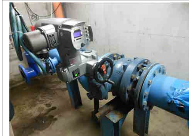
パイロットエリア1 (セクター18) チャンバー内 (減圧弁)
