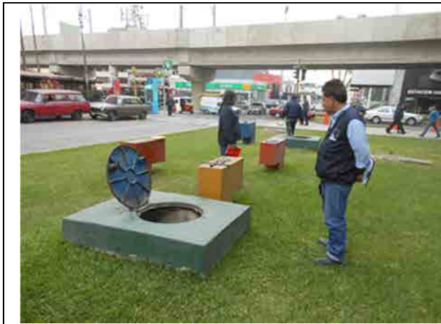
パイロットエリア2 (セクター67) 流入部チャンバー (流量計・水圧計等計器設置)
