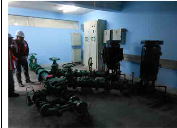
パイロットエリア2 (セクター67) 配水ポンプ場内
