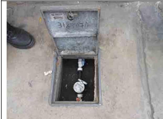
パイロットエリア2 (セクター67) 水道メーター
