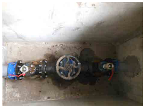
パイロットエリア1 (セクター18) チャンバー内 (流量計・水圧計等)
