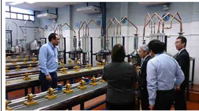
水道メーター検査設備 (SEDAPAL 本社内)
