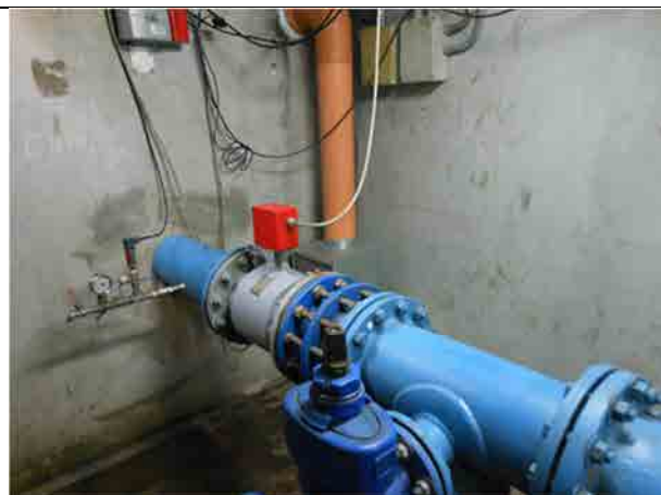
パイロットエリア1 (セクター18) チャンバー内 (電磁流量計・水圧計)
