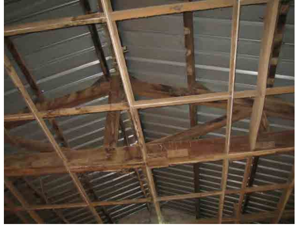
多くの学校では天井がなくなるか、あるいは穴が開いて雨漏りがしている。
