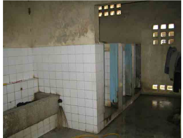
特にトイレなどの付属施設が老朽化のため使用できなくなっているところが多い。
