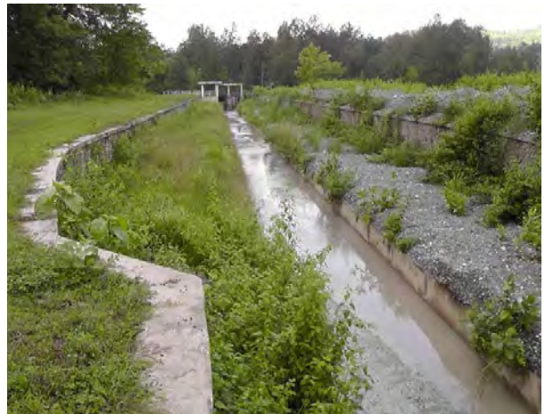
カラウルン灌漑地区の取水工の下流に設置されてい る沈砂池
