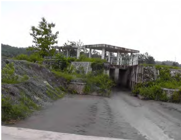
カラウルン灌漑地区の沈砂池下流部 (沈砂池、灌漑水路は堆砂で埋まっており、 取水ができない状況にある)
