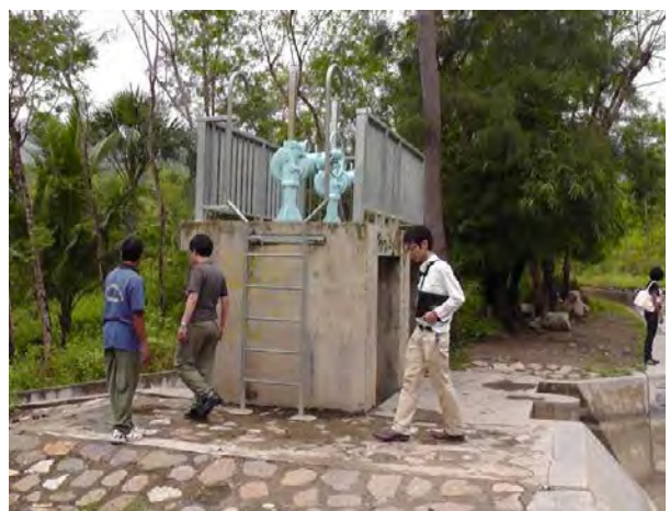
堆砂排出用の放流工 （右側が幹線水路で左方向へ放流されている）
