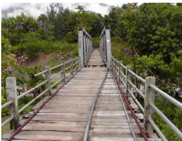
水管橋 （手前がコンクリート製の水管橋で鋼性水管橋との 接合部分の橋脚が傾き途中で段差が生じている）
