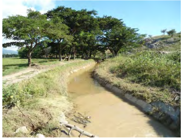
Seical 川中流に位置する Seical Up 灌漑地区の 灌漑水路 (取水工は 12km 上流に位置する)
