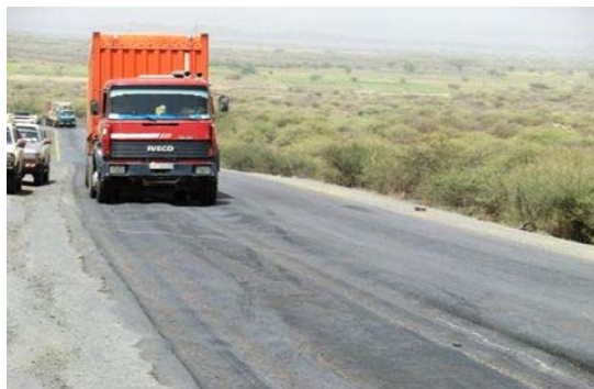
写真2-3. アスファルトの流動化によるわだち掘れの事例。勾配区間は走行速度が超低速となることもあって、わだち掘れが著しい。（エチオピア国道1号線）
