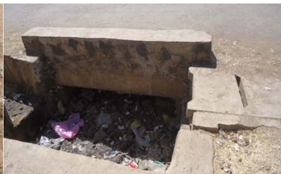
写真 2-27. ゴミ捨て場と化した横断函渠。
