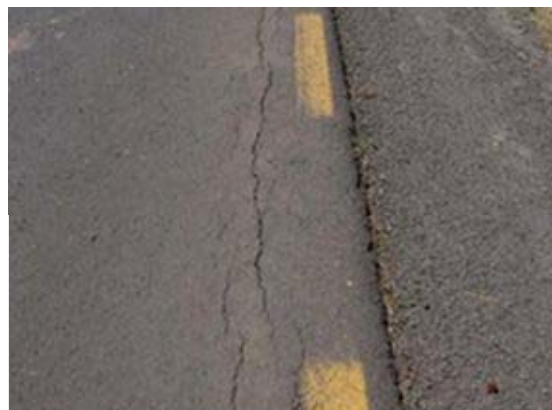
写真2-17. エチオピア国：地方部幹線道路 ブラックコットンソイルによる舗装破壊の典型的初期症状（舗装端部の縦クラック）。
