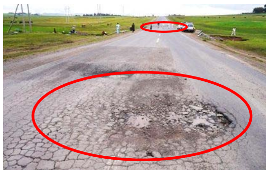
写真2-2. 縦断勾配のサグ部（一番低い部分）では、主として路盤内の水が飽和して舗装破壊の原因となっていると考えられる。橋梁を挟んで両側対称の位置に破損が見られる。
