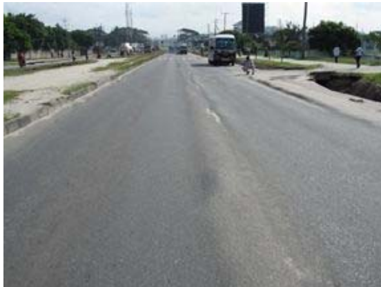
写真2-8. タンザニア国：ほぼ平坦な地形の都市部幹線道路で発生したわだち掘れ。車線表層部が中央側に流動している。
