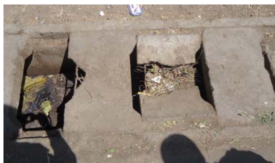
写真 2-28. 重量車両により破壊された側溝蓋。
