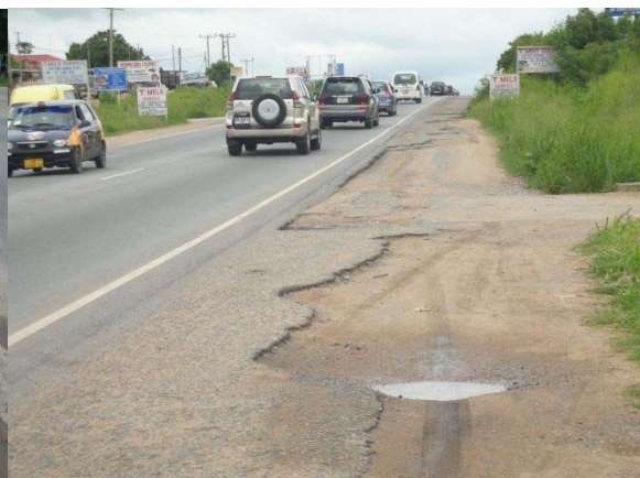
写真 2-21. ガーナ国：国道 1 号線（無償資金協力） 路肩部の簡易舗装はほぼ破損している。乗り入れ部 の車両に対しては本線と同じ舗装が必要。
