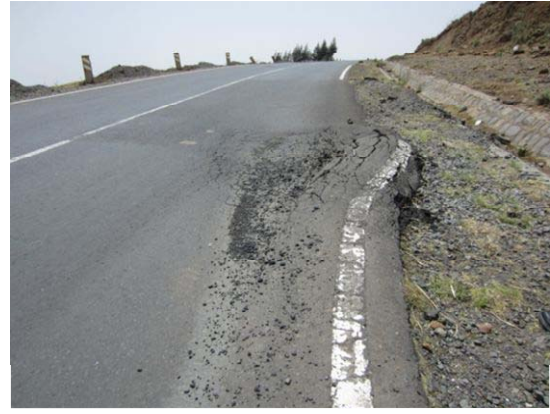
写真2-11. エチオピア国：地方部幹線道路 右山側からの地下水の影響により、支持力が低下し破損した舗装。
