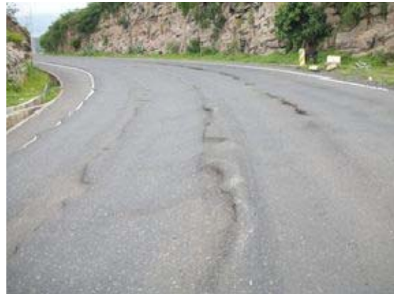
写真2-9. エチオピア国：急峻な山岳部の地方部幹線道路で発生したわだち掘れ。急勾配の曲線区間であり、表層が曲線の内側へ流動している。
