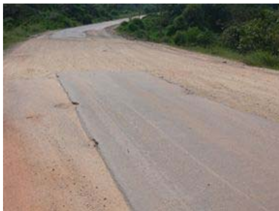
写真2-12. ガーナ国：地方部幹線道路（2007年） 水みち区間（表流水の集中区間）における舗装の喪失。
