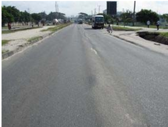
写真3-1. タンザニア国：ほぼ平坦な地形の都市部幹線道路で発生したわだち掘れ。車線表層部が中央側に流動している。
