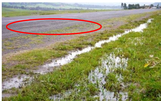
写真2-1. 山側（写真の右側）から流下する地下水が山側車線の舗装破壊の原因となっている。側溝の大型化、あるいは暗渠設置などによる排水の改善が必要。
