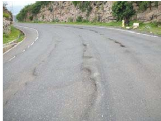
写真3-2. エチオピア国：急峻な山岳部の地方部幹線道路で発生したわだち掘れ。急勾配の曲線区間であり、表層が曲線の内側へ流動している。
