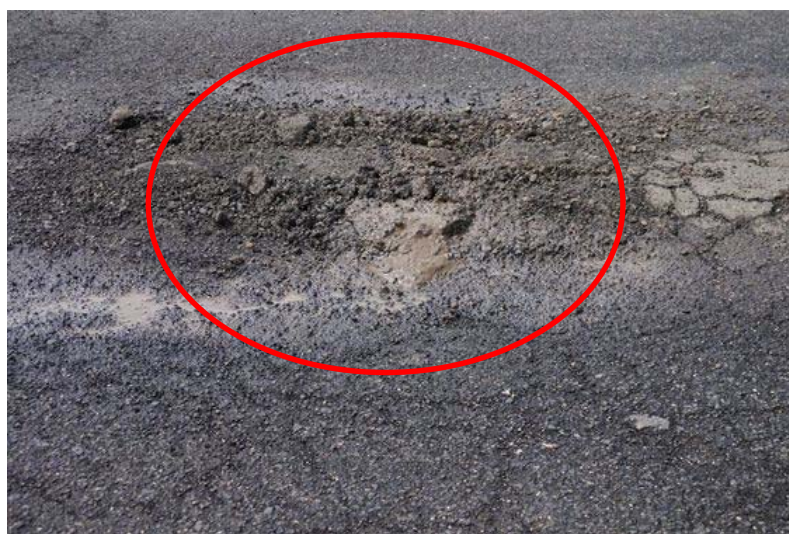
写真2-13. 路盤からポンピングにより泥水（どこに由来するかは不明）が噴出するアスファルト舗装（エチオピア国道3号線）。
