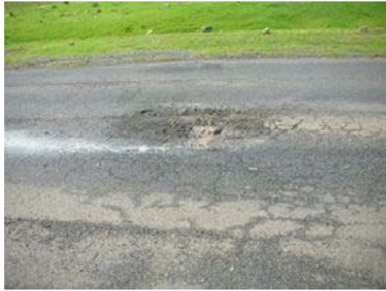
写真2-10. エチオピア国：地方部幹線道路 サグ部における水の影響により支持力が低下し破損した舗装。
