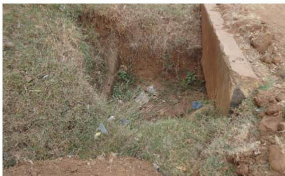
写真 2-26. 土砂で埋まった横断管。
