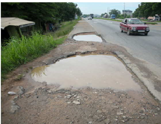
写真 2-20. ガーナ国：国道 6 号線市街地近郊 路肩を利用した駐停車が多い区間であるにもかかわらず、簡易舗装を採用した事例。
