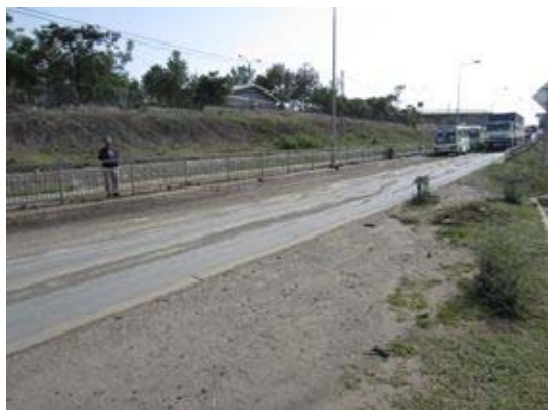
写真2-16. エチオピア国：都市部幹線道路 ブラックコットンソイルの影響により、舗装下部の支持力が低下し、表面にわだち掘れが発生したものの。
