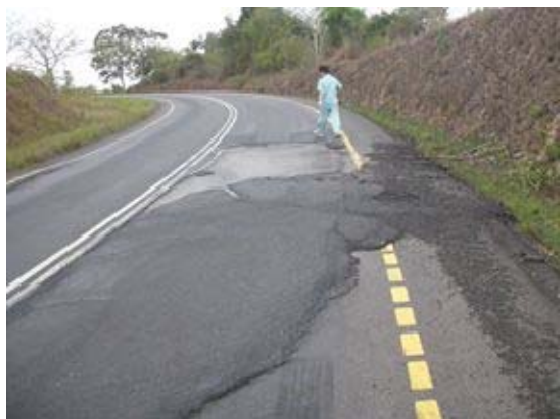
写真2-6. 縦断勾配の急な曲線区間に発生した舗装のずれ。
