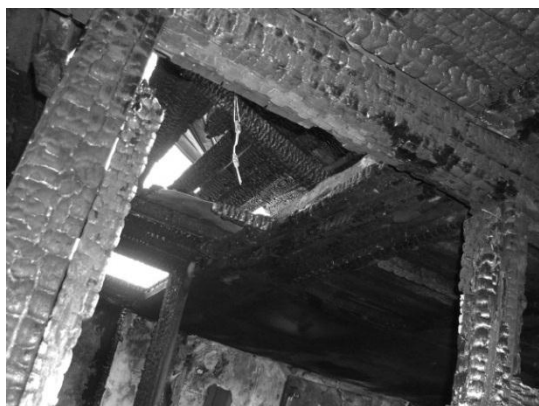
Зураг 19 Дээврийн жижиг хэсэг бүрэн шатаж холцорч унасан байдал
