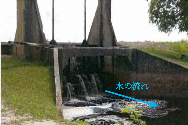
写真-6 マドゥニ放流工ゲートの漏水状況 経年劣化のために木製ゲートから漏水している。 ゲートの付け替えを行う。
