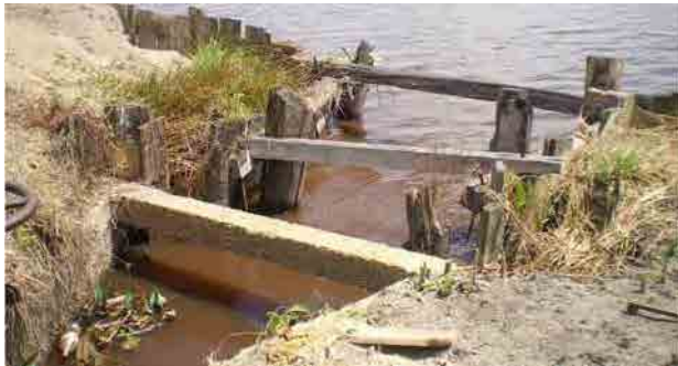
写真-14 シャンクス取水工の現況 木製擁壁工の老朽化が進行している。抜本的改修が実施され、既設取水工は埋戻し処理される。
