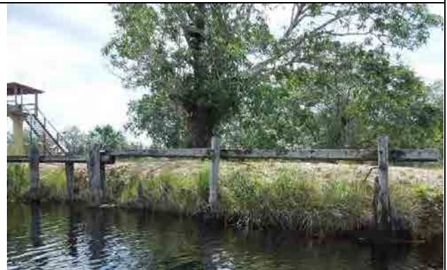
写真-5 マドウニ放流工；朽ち果てた木製護岸工と 背後で自立・安定状態の盛土斜面
