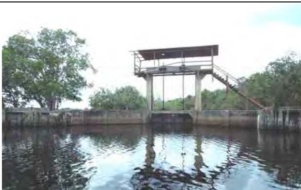
写真-4 マドウニ放流工正面、放流工ゲート～擁壁工 ～木杭護岸工
