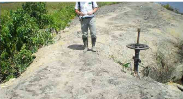
写真 3-1-18 やせて狭い盛土天端幅
