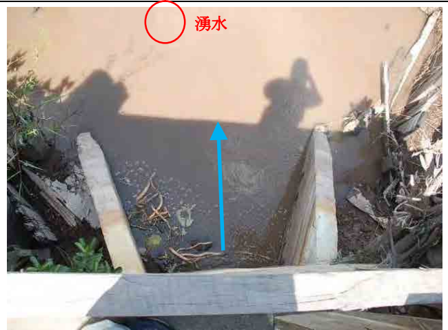
写真-19 ホープ取水工・吐口側の漏水・湧水状況 現既設取水工改修に際し残置した旧取水工の樋管からの漏水ということである。既設取水工の埋戻し処理時に止水矢板により処置する。
