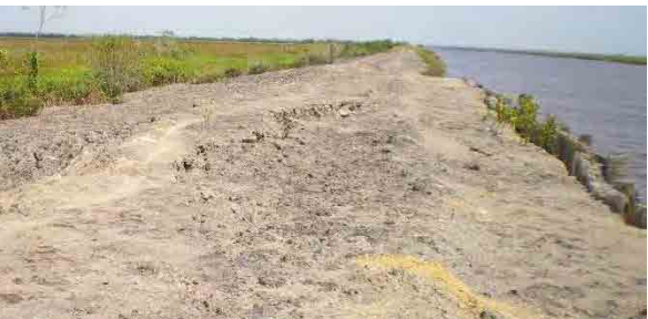
写真 3-1-20 滑りにより段差が生じた盛土天端
