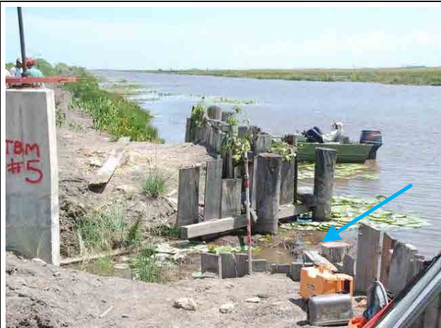
写真-18 ホープ取水工・呑口側の状況 木製擁壁工の老朽化が進行している。取水工本体の抜本的改修を行い、既設取水工内は埋戻し処理する。
