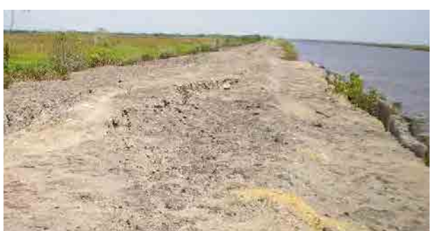
写真-17 シャンクス取水工部の盛土状況 呑口部正面右側約 20m 地点で、上流斜面の滑りのために段差が生じている。
