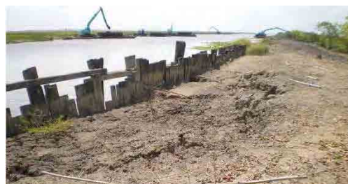
写真 3-1-4 天端の沈下、クラック、護岸工の傾斜
