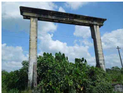
写真 3-1-22' クニア下流調節ゲートの巻き上げ機支柱
