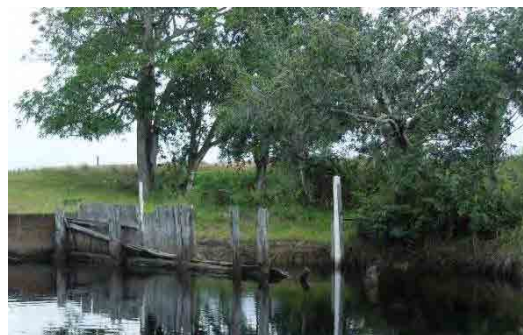
写真 3-1-30 朽ちた木製シートパイル と自立状態の地山斜面
