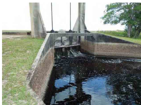
写真 3-1-28 木製ゲートからの漏水状況
