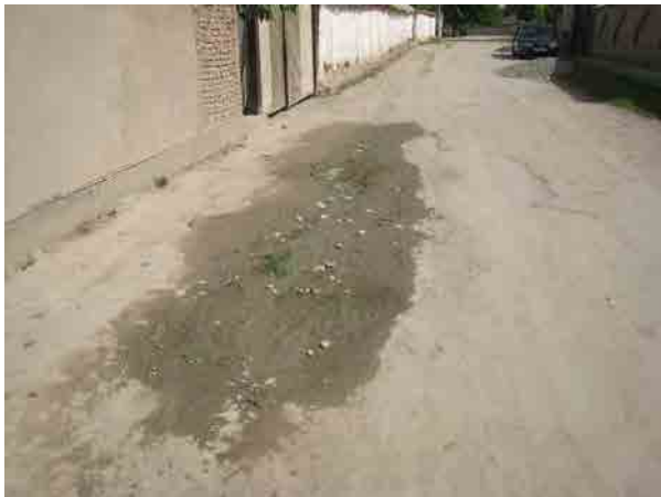
写真9：ピアンジ町内の漏水状況 既存の配水管は老朽化のため漏水を生じている。保守用機材がないため、適切な修理ができない。
