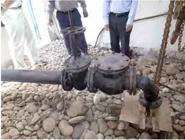
写真7：ボドカナルの既存深井戸（No.3） 井戸から大量の砂を吸い上げた結果、井戸周りの地盤が陥没し、使用不能となっている。
