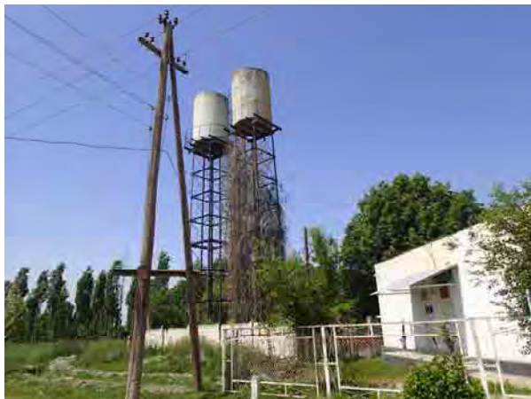
写真11：サルマントイ1村の既存高架水槽 2003年に井戸ポンプが故障して以来、放置されており、復旧するのは困難と判断される。
