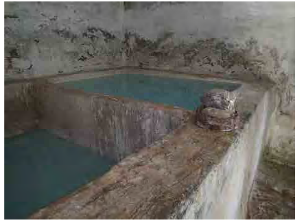
写真8：ボドカナルの既存消毒設備 さらし粉の溶解槽から井戸への吸引管が目詰まりしており、正常な消毒処理ができない。
