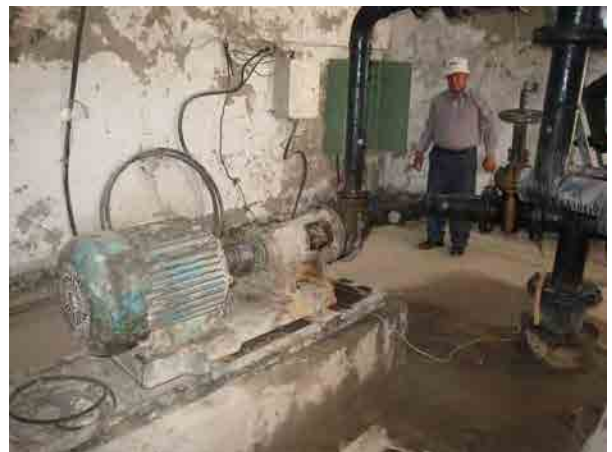
写真6：ボドカナルの既存深井戸（No.5） 井戸の建設材料が粗悪で、井戸水に砂が混入するため、ポンプが頻繁に故障する原因となっている。
