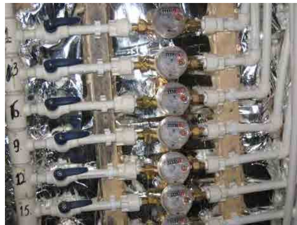
写真 18：ホジャンド市水道公社の水道メーター
