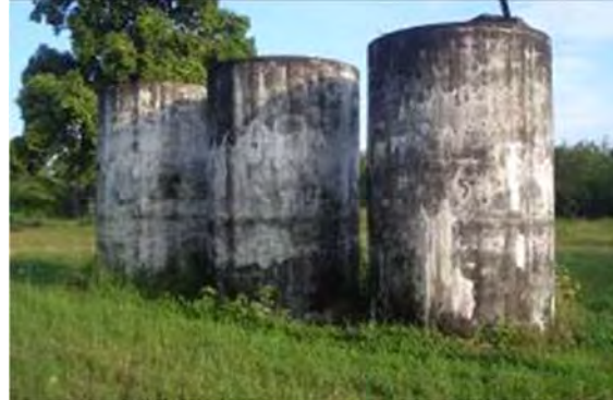
Pic: Tanks (F. 33)
