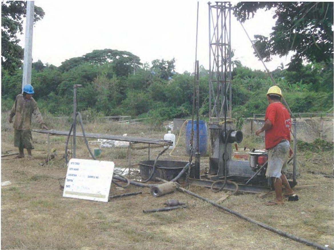
รูปแสดงการเจาะสำรวจและตอกทดสอบบริเวณหลุมเจาะ BH-19
